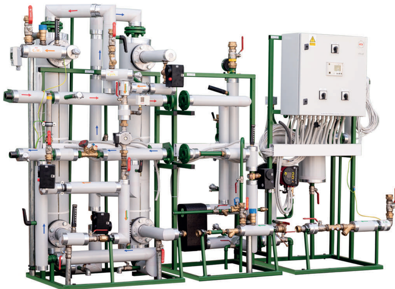
Węzeł c.o. i c.w.u. pracujący w układzie szeregowo-równoległym. Na c.w.u. wymienniki typu JAD
